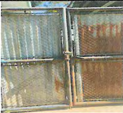
Foto9: El portón se encuentra en mal estado, el candado a menudo se llena de oxido debido a las lluvias y no brinda una mayor sdeuridad.
