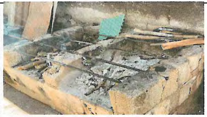
Foto 8: Los polletones de la cocina estan bastantes dañados lo que que provoca incomodidad para preparar los alimentos del programa.
