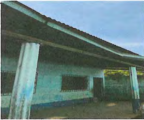
Foto7: La pintura de las paredes exteriores está deteriorada lo cual causa una aspecto poco agradable para los estudiantes.
